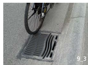
Grille d'égout adaptée aux vélos (Ipsach)
